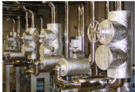
給水ポンプ廻り 仕切弁 逆止弁
