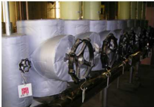
蒸気ヘッダーバルブ
