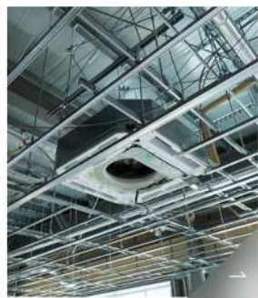
空調設備事業 空調・給排水設備・冷媒フロン回収
