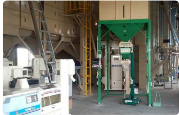
ライスセンター乾燥機7基
