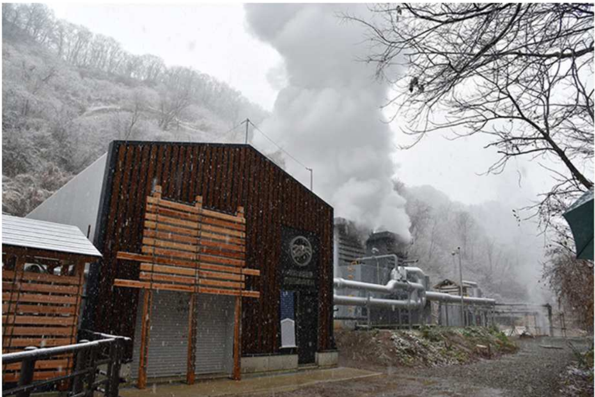
【松之山温泉にある発電設備】
